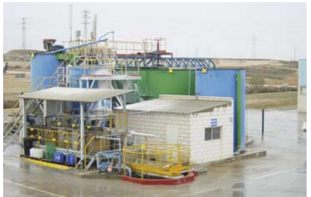
DEPURADORA FÍSICO-QUÍMICA – TUDOR
