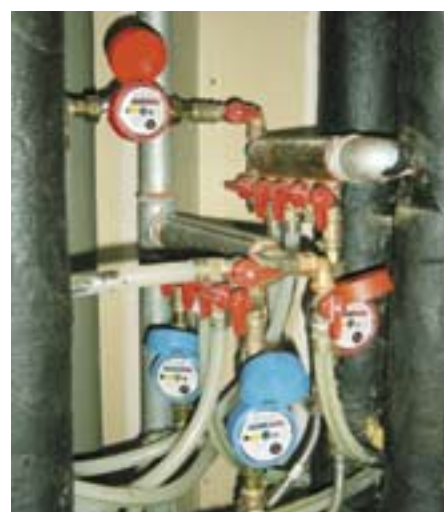
CONTADORES AGUA FRÍA Y CALIENTE - HOTEL BOSTON
