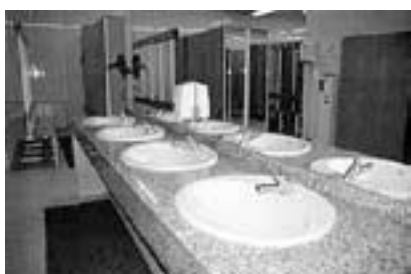
LAVABOS CON GRIFOS TEMPORIZADOS - GIMNASIO I.F.C.
