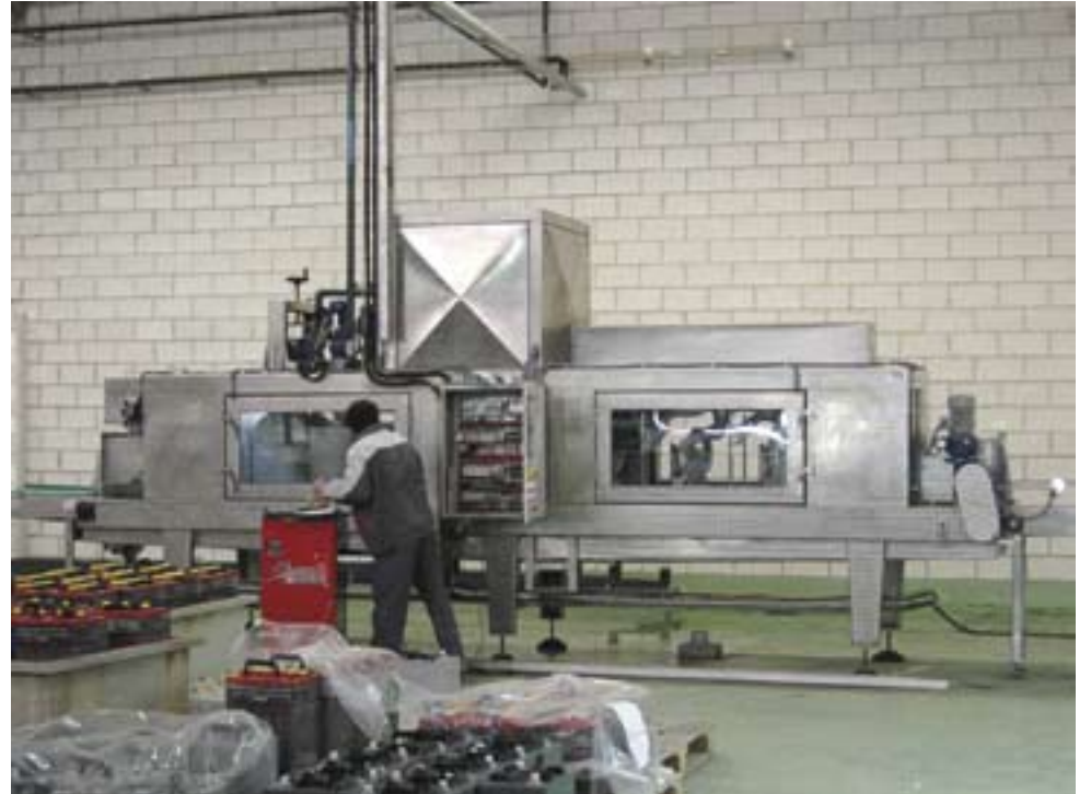
MÁQUINA LAVADO AUTOMÁTICO CON AGUA RECICLADA DE LA DEPURADORA – TUDOR
