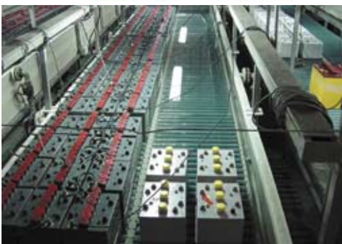
REFRIGERACIÓN BATERÍAS CON AGUA RECICLADA DE LA DEPURADORA – TUDOR
