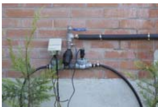
DETALLE INSTALACIÓN RIEGO – EUPLA
