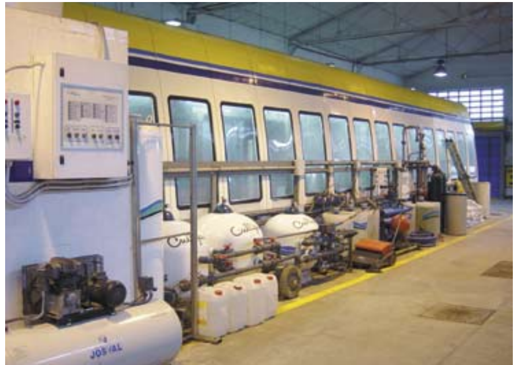
INSTALACIÓN DE REUTILIZACIÓN AGUA - LAVADO COCHES TÚNEL
