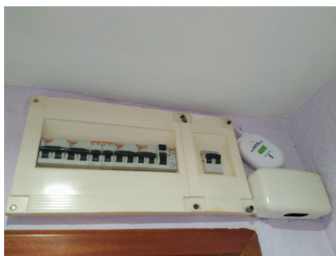
Figura 9. Monitor de consumos eléctricos en cuadro general en la vivienda de Fermín Gil en Las Fuentes
