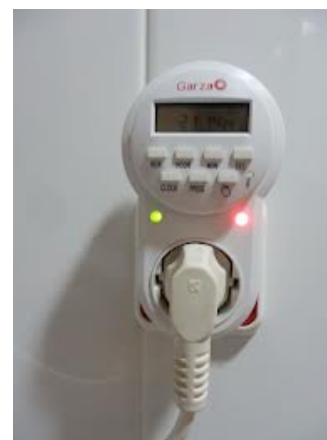
Foto. Temporizador en termo eléctrico
